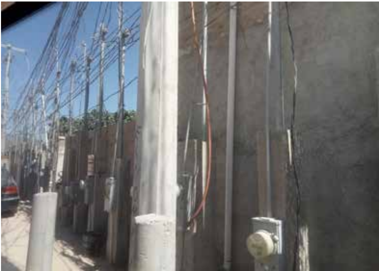
Figura 8. Zona de postes de conexión de energía eléctrica. Fuente: Mayra Gutiérrez-González, septiembre de 2022.
