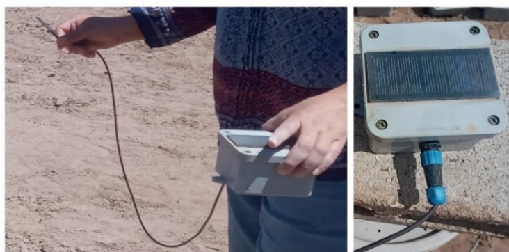
Figura 15. Sensor de temperatura DS1822 equipado con un microcontrolador y panel solar.
